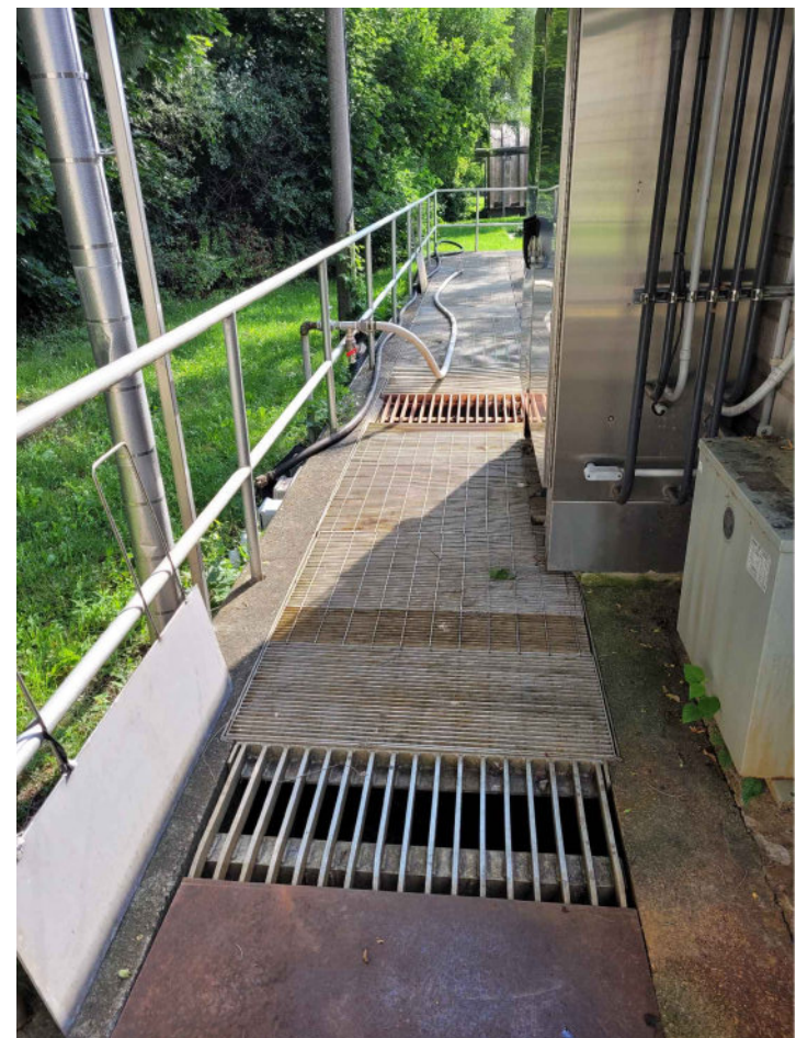
PHOTO No. 3 - INLET BAR SCREENS N.T.S.
